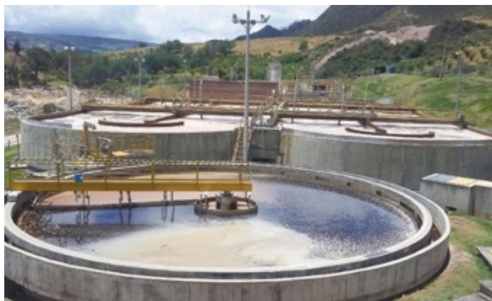
Figura 2. Planta de tratamiento de lixiviados.
